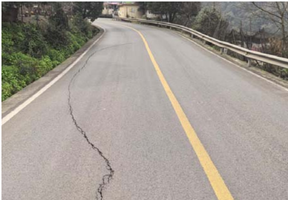
路面沉陷病害图
