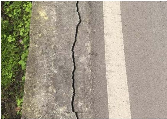
路肩破损病害图
