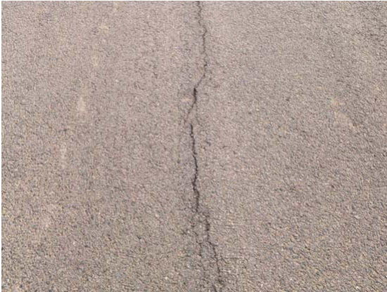
纵横裂缝病害图
